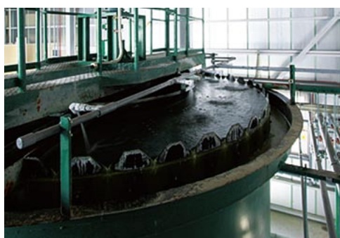
排水処理プラント
