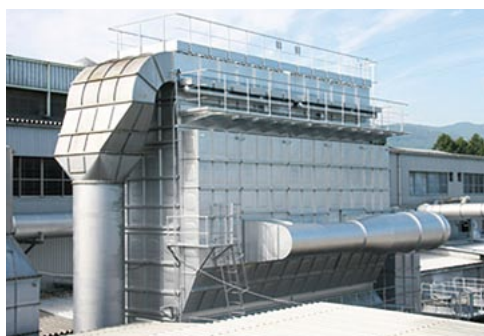
煤煙処理装置
